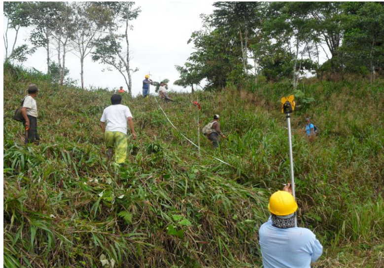
Trazado de la línea de bandera, abriendo trocha para avanzar con la topografía.
