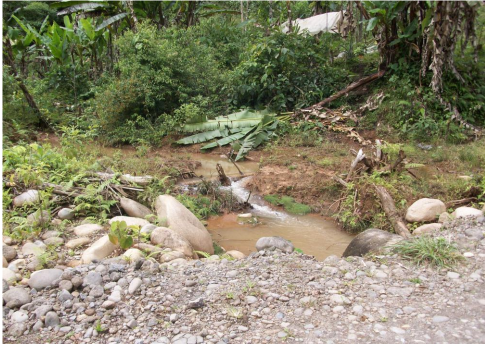
Alcantarilla en la abscisa 3+520 de tubo circular de hormigón.
